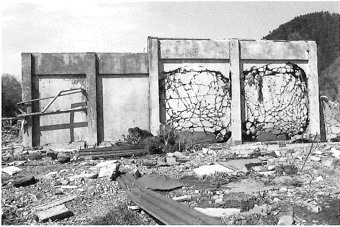
波圧で崩壊した RC 造壁
