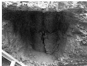
大野小学校杭頭破壊
